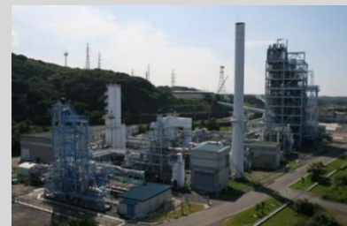
(パイロットプラント)
