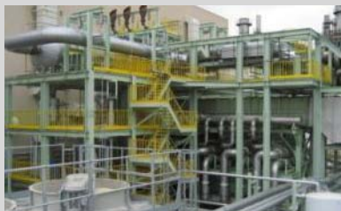
(40MW級総合試験設備)
